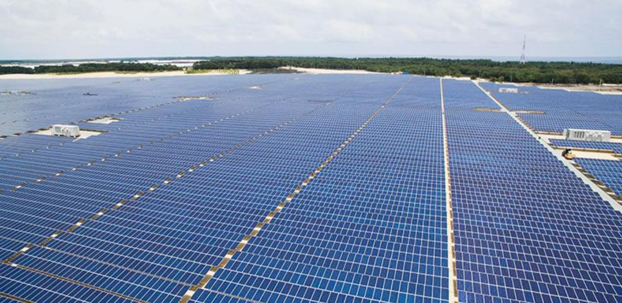
Nhà máy Điện mặt trời TTC Phong Điền
